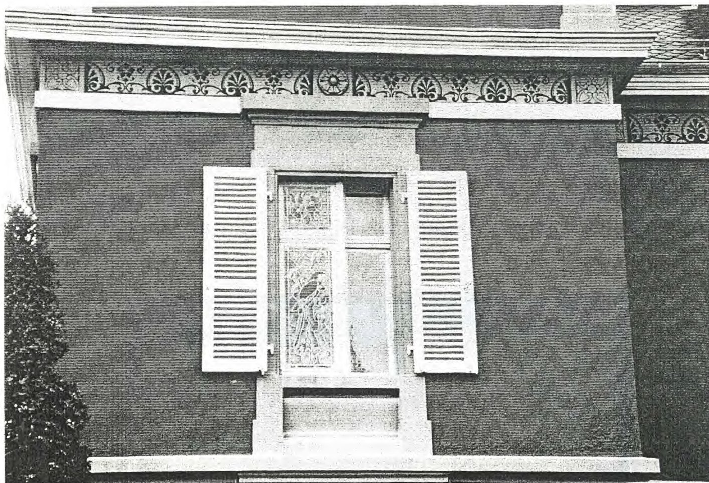
An der Nordfassade wurde das halbe Blindfenster im Obergeschoss mit einer "trompe-l'oeil"-Malerei versehen.
