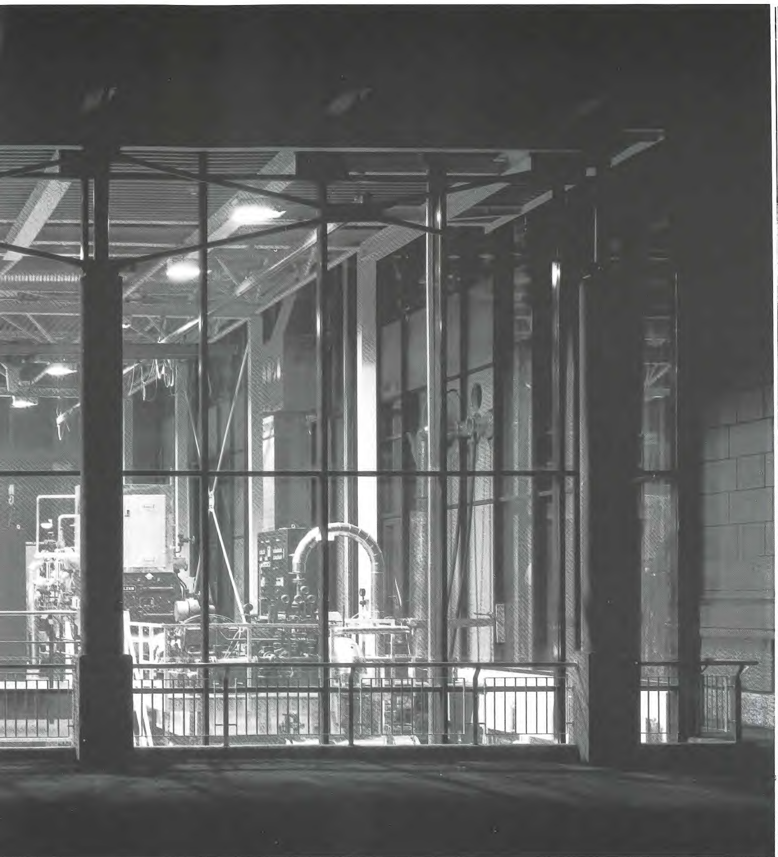
Die Maschinenhalle. Detailausschnitt Ecke Hof/Altbau E. Dampfkessel und Turbine.
