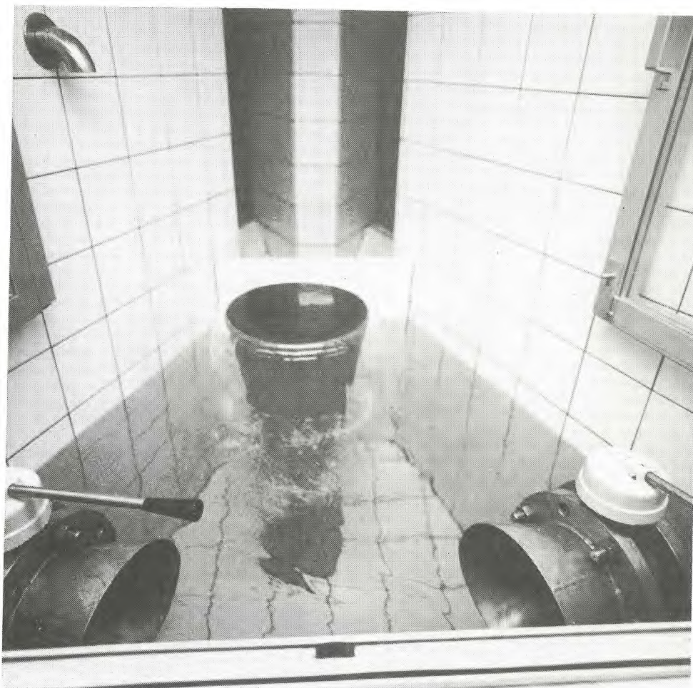
Freilaufkasten Quellwasser mit Abgangsleitungen vorn : Zuleitung in die zwei Behälter von je 300 m 3 hinten : Ueberläufe
