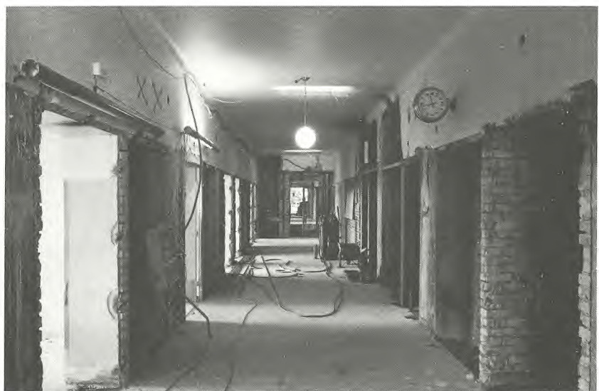
12 Korridor während des Umbaus: der Bau ist nahezu in einen Rohbauzustand versetzt, 1986
