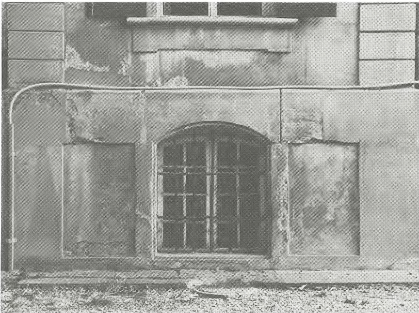
Haussockel Nordwestseite. Der Sandstein ist mit Zementmörtel repariert. Die Sandstein-Bodenplatten wurden überbetoniert.
