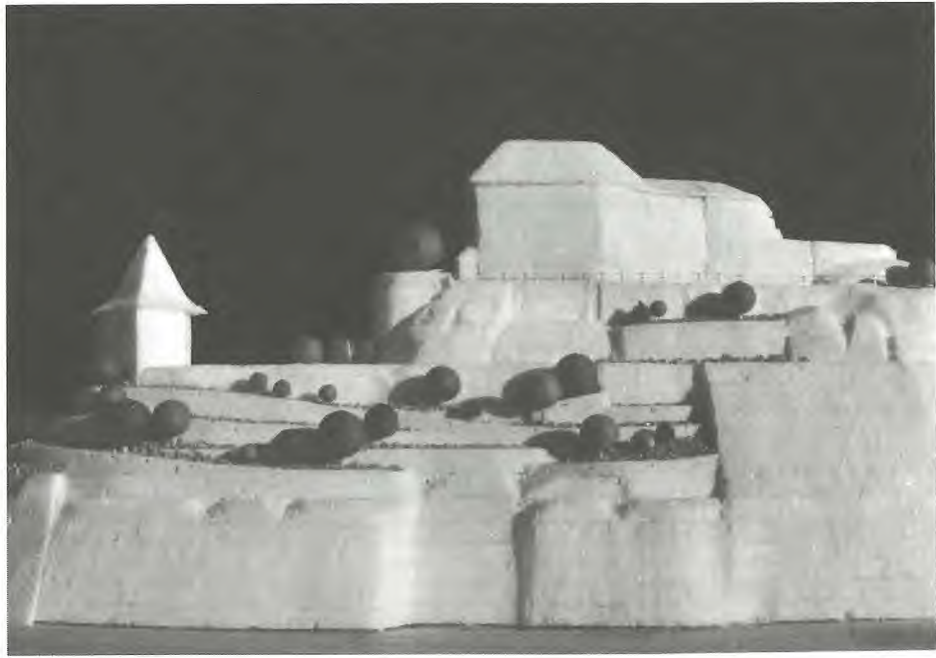
Oben: Modell der Felssanierung als Diskussionsgrundlage. Unten: Schäden an der Verbauung 1923/25 und Schalenstruktur des Felsens, Zustand 1979.
