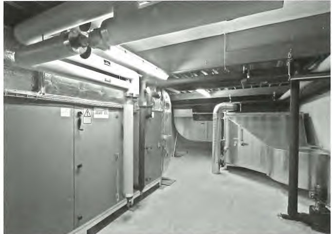
Neue Installationen im Technikraum über dem Produktionsbereich
