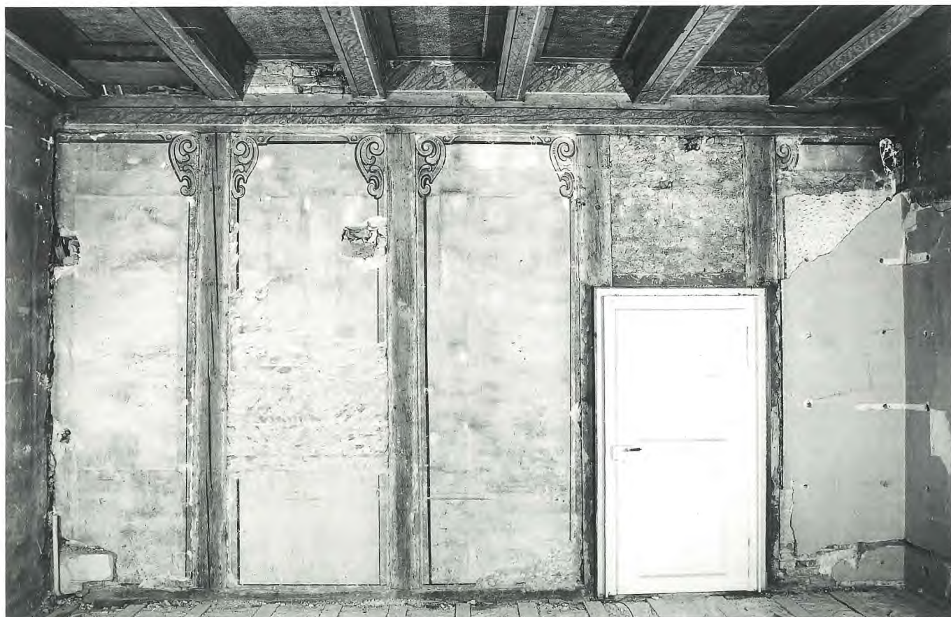
Repräsentationsraum im 3. Obergeschoss Nord. Fundzustand der Wand- und Deckenmalerei aus der Zeit um 1630/50.
