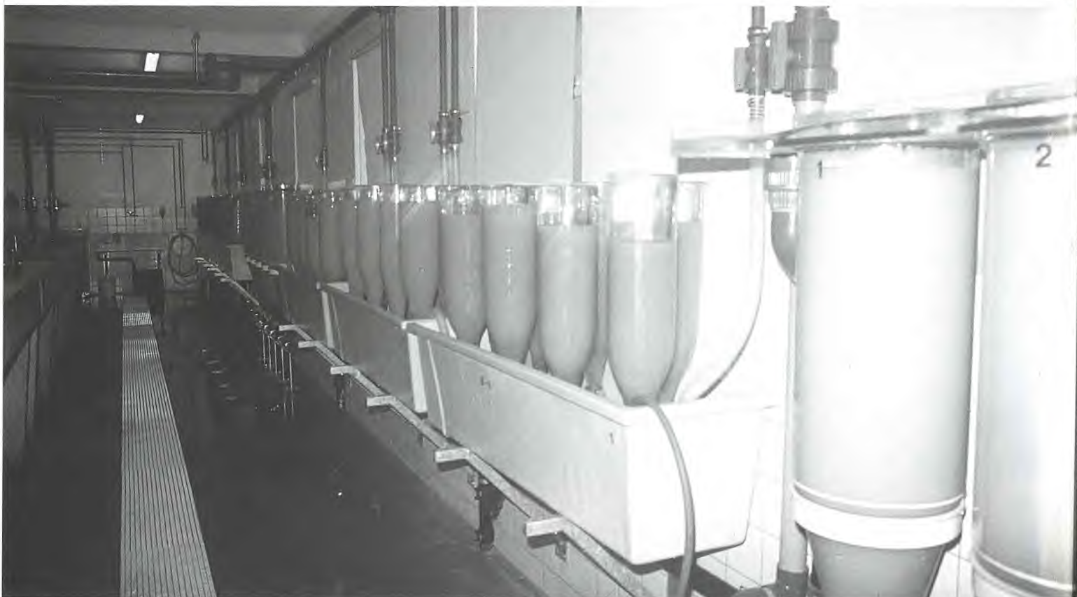
Erbrütungseinheiten in Zylindern und Zugergläsern nach dem Umbau
