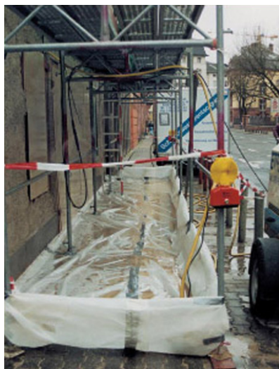
√: Auffangvorrichtung für Abwasser
