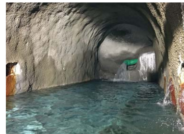
Eine ältere Quelfassung im Bernbiet. Ergiebige Grundwasservorkommen mit einer einwandfreien Trinkwasserqualität sind aufgrund der intensiven Nutzung unseres Lebensraums immer schwieriger zu erschliessen.
