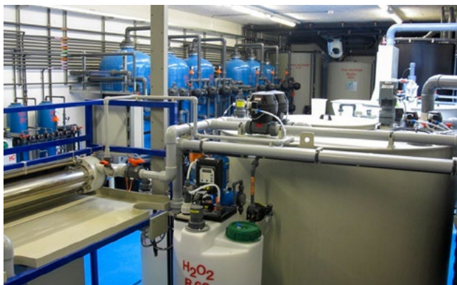
Abwasservorbehandlung Galvanikbetrieb. © AWA
