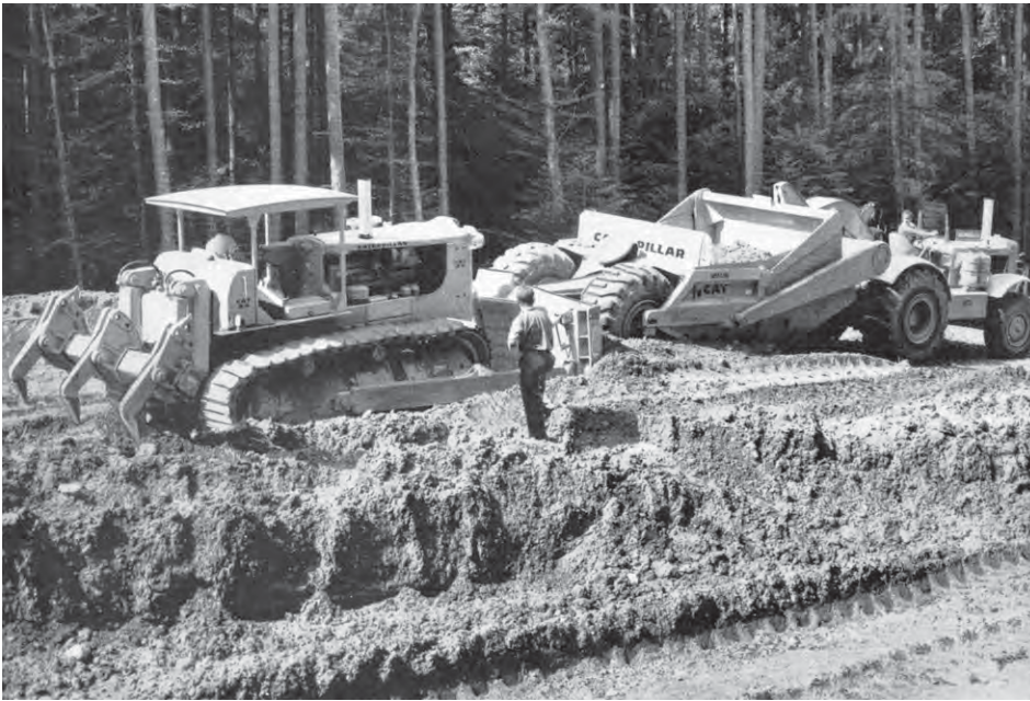
Abb. 51 (oben): Bulldozer und Scraper bei den ersten Autobahnarbeiten an der N1 im Grauholz im Jahr 1959. Zum ersten Mal seit dem Kunststrassenbau der ersten Hälfte des 19. Jahrhunderts wurden wieder im grossen Stil neue Strassen auf vollständig neuer Linienführung gebaut. Die dabei zum Einsatz gelangenden Baumaschinen übertrafen an Leistungsfähigkeit alles bisher in der Schweiz Gesehene. (Foto: Schweizer Autobahnen in Sicht, 1960, 20)
