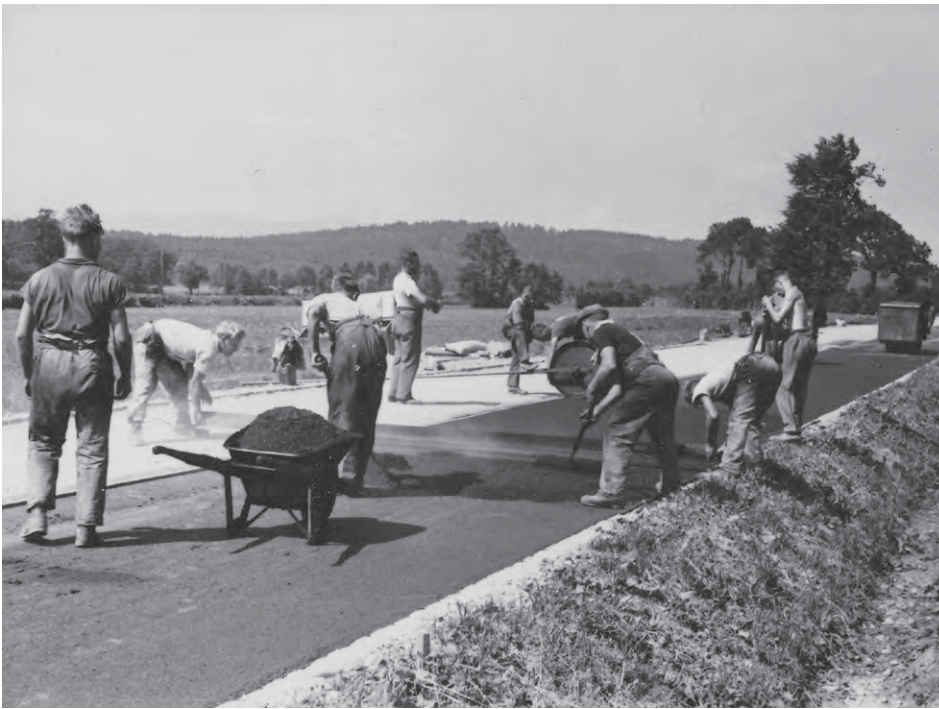
Abb. 38 und 39 (linke Seite): Strassenkorrektur Steinbach, Kreuzung Belp, ausgeführt durch die Firma Rudolf Schwenk Hoch- & Tiefbau, Belp, im Jahr 1937. (Fotos: Tiefbauamt, Oberingenieurkreis II, Bern)
