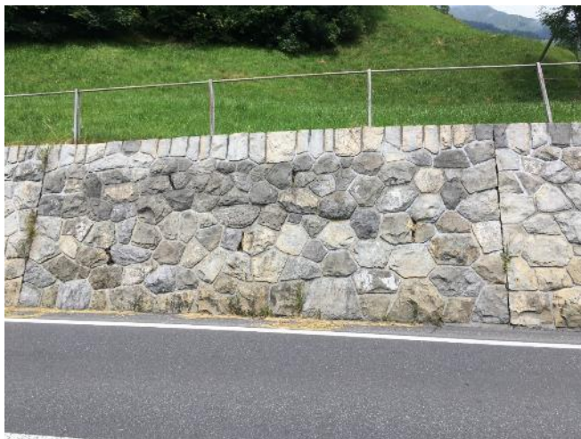
Abb. 41: Gutes Beispiel eines sorgfältig gebauten Zyklopenmauerwerks mit Roll-schar (Dilatationsfugen wirken störend)
