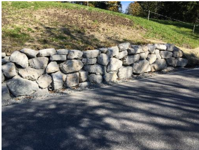
Abb. 53: Gestalterisch und konstruktiv sehr schlechte Lösung mit zu grossen Steinen, sehr unebener Maueroberfläche und zu uneinheitlichem Fugenbild; Stützmauer wirkt instabil
