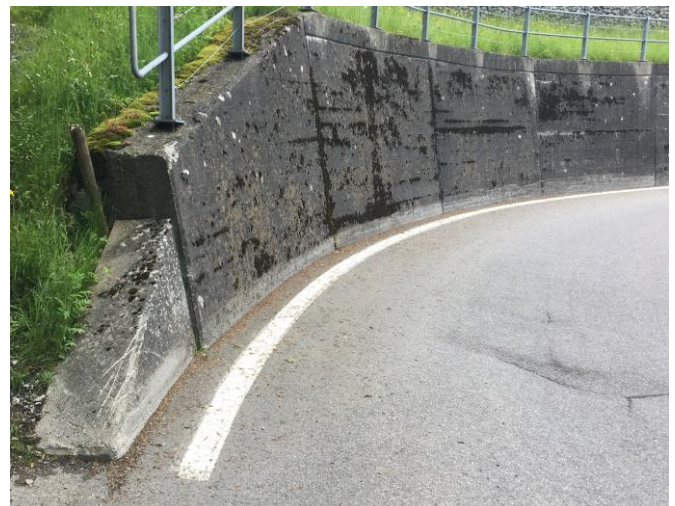
Abb. 12: Mauer ist zu kurz und wurde unsorgfältig verlängert (gestalterisch schlechte Lösung)
