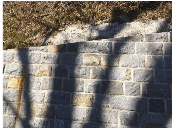
Abb. 40: Schichtenmauerwerk ohne Roll-schar verursacht spitzwinklig auslaufende Steine und dadurch eine reduzierte Dauerhaftigkeit; es wirkt so zudem nicht materialgerecht (ge-stalterisch ungünstige Lösung)
