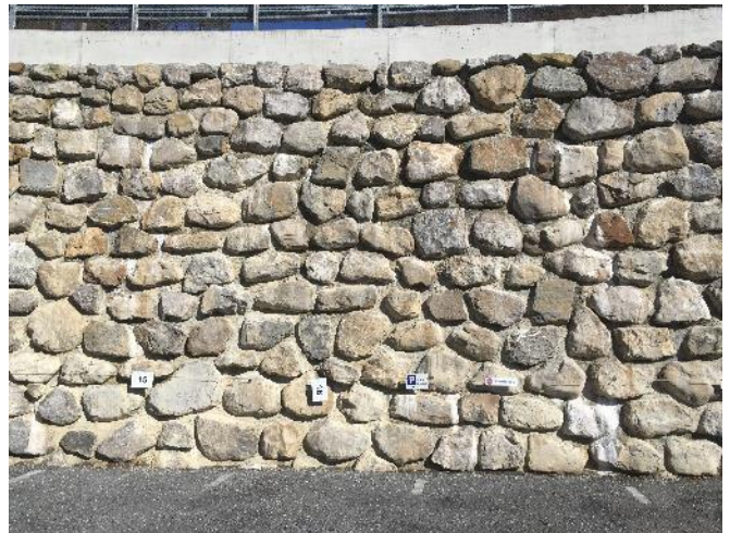
Abb. 54: Gestalterisch unglückliche Lösung mit im Verhältnis zur Mauerhöhe zu kleinen Steinen, zu unebener Maueroberfläche, zu grossen und zu uneinheitlichen Fugenbreiten; verwendet wurden viele rundliche Steine, die ungeeignet sind und zum unschönen Fugenbild mit stellenweise durchlaufenden Fugen beitragen
