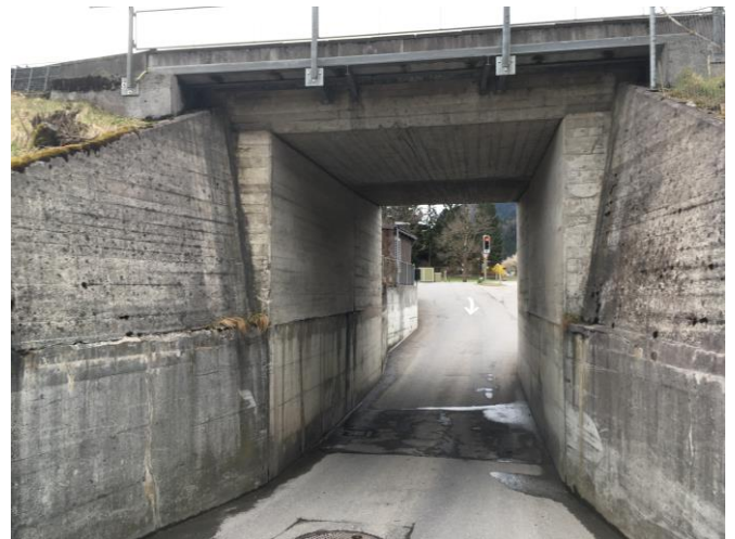
Abb. 26: Gesamtbauwerk wirkt massiv und schwerfällig; wechselnde Neigung der Stützmauern trägt wesentlich zur unschönen Lösung bei
