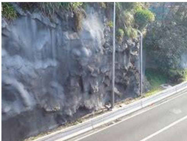
Abb. 68: Gestalterisch ungünstige Felssicherung mit Verschleifen resp. Ausfransen in die Felsoberfläche
