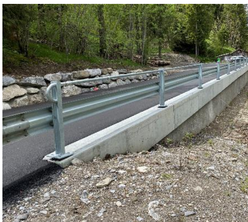
Abb. 71: Gutes Beispiel einer Bordüre über einer Spritzbetonmauer; Bordüre ist vorstehend und polygonal (Beachte: Gasrohre als Handlauf stellen einen Gefahrenherd beim Aufprall von Fahrzeugen dar)
