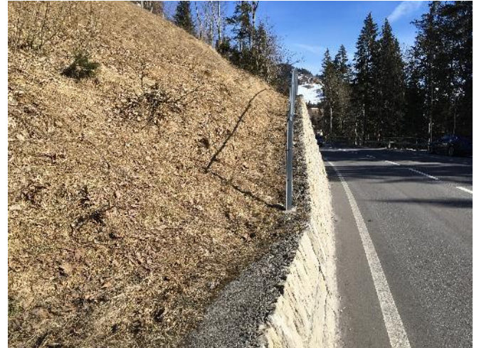
Abb. 43: Beispiel einer Mauerkrone mit minimalem Überstand zu gewachsenem Terrain und zu schmalen Unterhaltsweg auf der Mauerkrone; unnötiges Geländer
