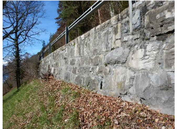
Abb. 10: Die Steilböschung ist ohne Berme an die Stützmauer angeschlossen (für den Unterhalt sehr ungünstig)
