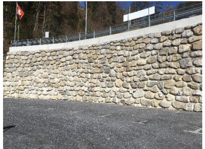
Abb. 50: Gestalterisch schlechte Lösung mit zurückversetzter Bordüre
