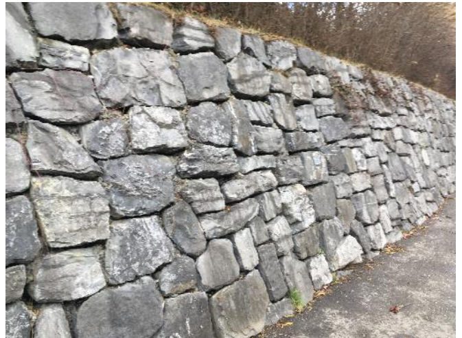
Abb. 56: Gutes Verhältnis von Steingrösse zu Mauerhöhe, ebene Oberfläche, schmale Fugen sowie gut ausgeführte Krone
