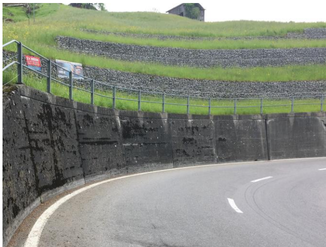
Abb. 72: Gutes Beispiel von Steinkörben als Hangsicherung oberhalb der ursprünglich doppelt so hohen Stützmauer; positive Wirkung dank der Distanz zwischen den unterschiedlichen Mauertypen
