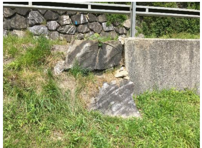
Abb. 8: Mauer zu kurz und mit Blöcken unsachgemäss ergänzt (gestalterisch ungünstige Lösung)
