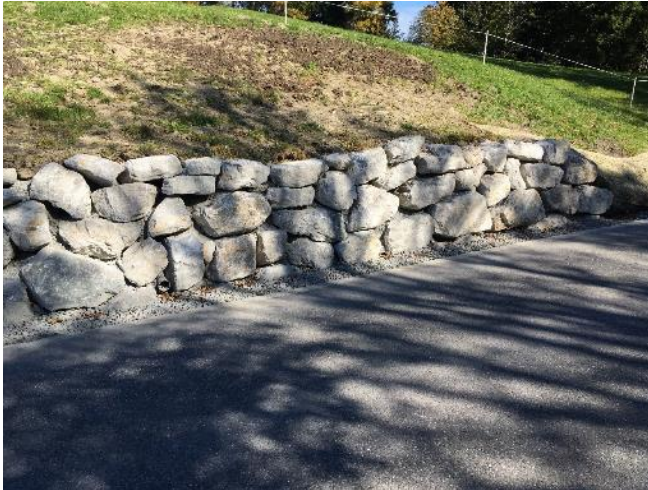
Abb. 43: Gestalterisch und konstruktiv sehr schlechte Lösung eines Natursteinmauerwerks; Stützmauer wirkt instabil
