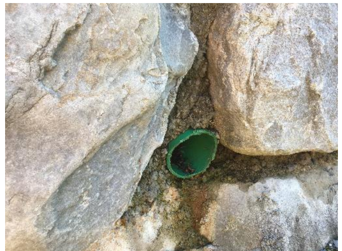
Abb. 65: Gestalterisch und technisch ungünstige Lösung der Entwässerung mit Kunststoffrohr
