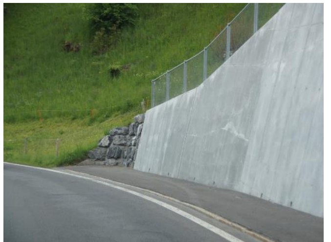
Abb. 18: Zu kurze Mauer: unschöne, deplatzierte Verlängerung mit Blocksatz (gestalterisch inakzeptable Lösung)
