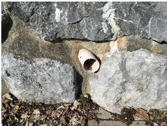
Abb. 64: Gestalterisch und technisch ungünstige Lösung der Entwässerung mit Kunststoffrohr
