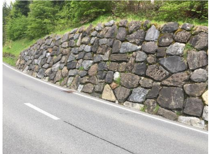
Abb. 52: Gutes Verhältnis von Steingrösse zu Mauerhöhe, ebene Fläche zur Strasse, maximal zulässige Fugengrösse eingehalten, jedoch zu unsteter Kronenverlauf
