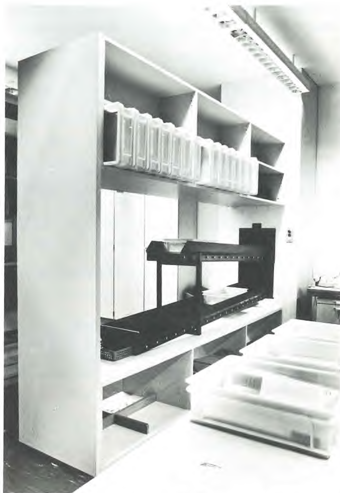
Behälteraufzug im Magazin, 1. Untergeschoss
