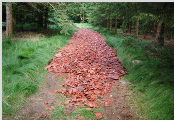
Pose non conforme de débris de tuiles
