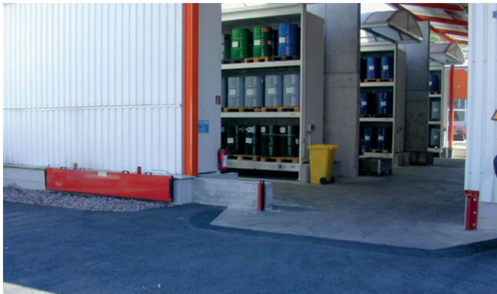
Barrière à eaux d'extinction manuelle
