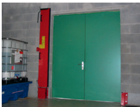
Barrière à eaux d'extinction semi-automatique
