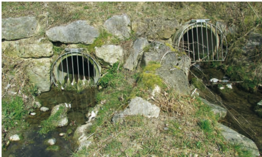
Fig. 2: Les points de déversement de l'évacuation des eaux des biens-fonds doivent être contrôlés périodiquement (exigence minimale n°9).
