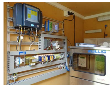
Grâce à cette station de mesure près de Bätterkinden (en haut), le LPES surveille les apports diffus de pesticides dans le Chrümmlisbach dont le bassin versant est largement voué à l'exploitation agricole. Les conteneurs de ce type abritent un échantillonneur automatique réfrigéré (en bas) et d'autres appareils techniques. Les écrans affichent la température, le pH, la conductibilité et le débit du cours d'eau.
