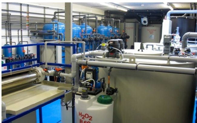
Pétraitement des eaux usées Entreprise de galvanisation. © OED
